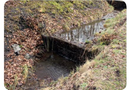
Une succession de palplanches bois ralentissent l'eau en parallèle d'un cheminement, Mission Bassin Minier
